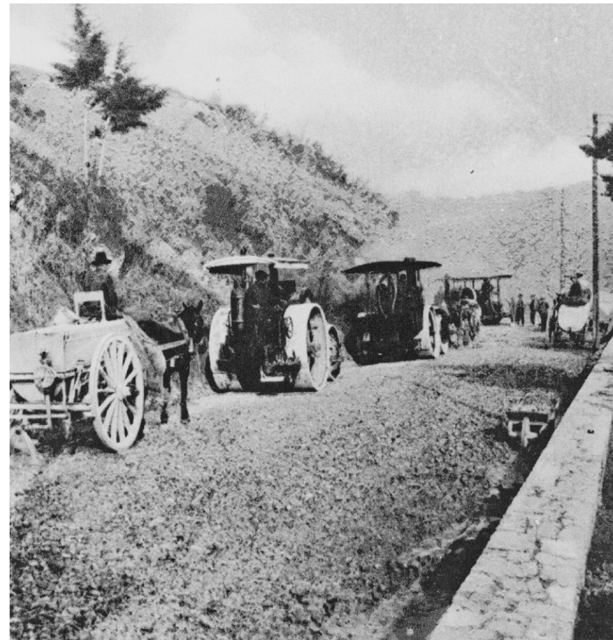
Lavori di allargamento della Strada delle Coste, durante il periodo di costruzione della Direttissima, alla fine degli anni Venti del Novecento (Archivio fotografico Fondazione CDSE, fondo Fiondi)
